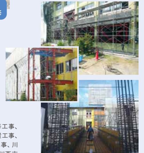
川西市立川西北小学校 耐震・EV新設・渡り廊下新設工事
